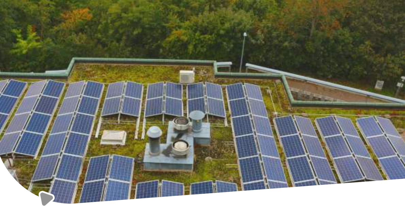
Gründach mit Photovoltaik-Anlage
